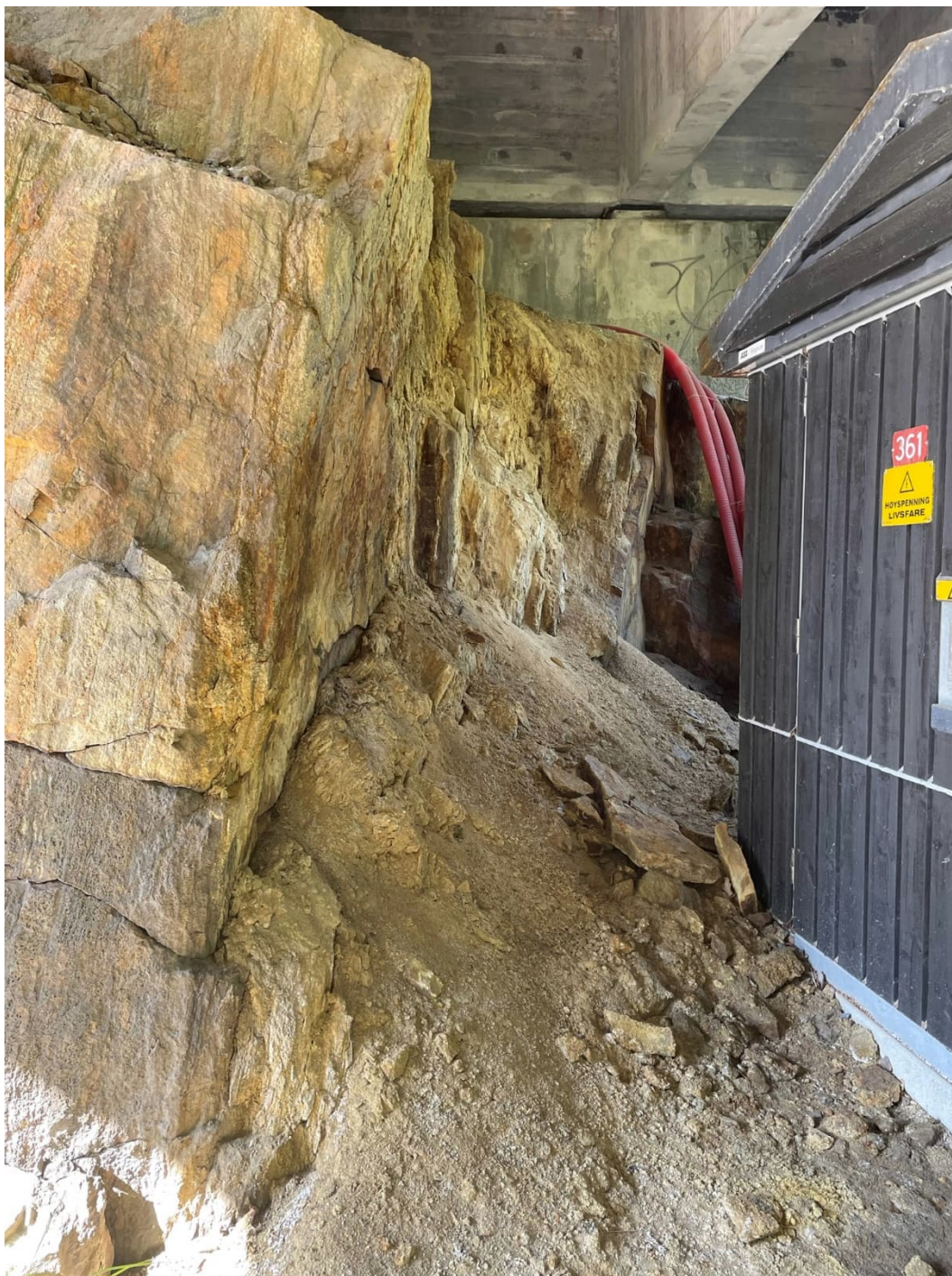
Figur 11-9: Sulfidførende sone under dagens sørlige brufundament på E18, ved ca. profil 6360. Fotograf: Ingvild Sangesland Qvist.
